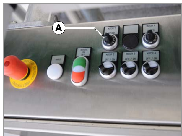
[15] Potentiometer (A) am Schaltschrank der Motorsteuerung (Beispiel: NOVEXX Solutions, Serie AMC).
