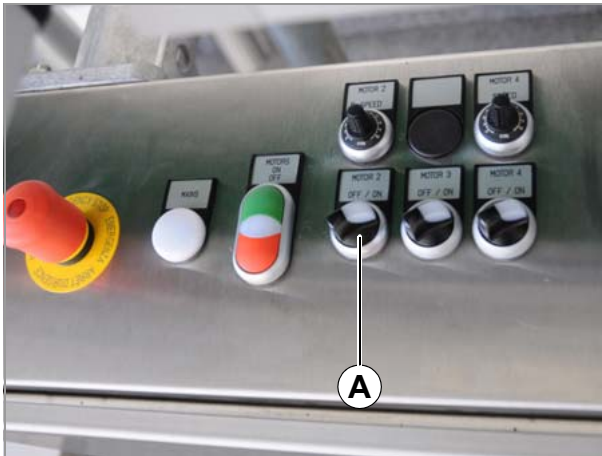
[6] Ein-/Ausschalter (A) am Schaltschrank der Motorsteuerung (Beispiel: NOVEXX Solutions, Serie AMC).
